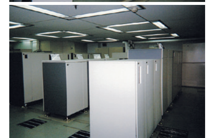
コンピュータマシンルーム
