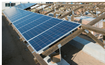
鹿島ソーラー発電所 架台 (茨城県)
