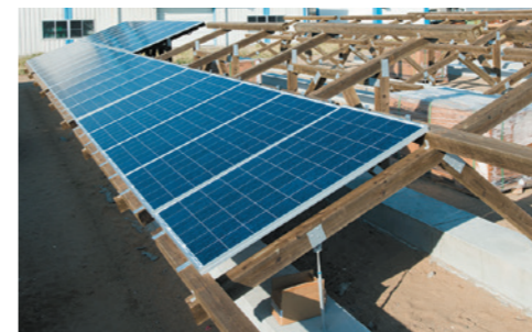
住友林業鹿島ソーラー発電所: 木製架台
