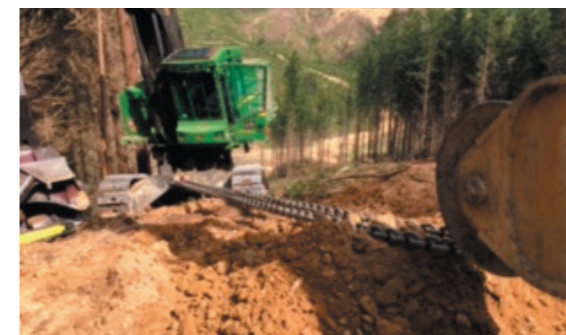
TPF社：テザーシステム現場
