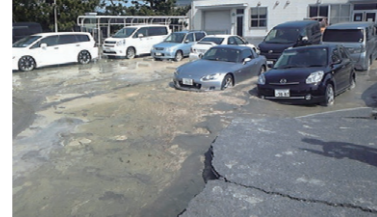
建物被害と液状化(住友林業クレスト鹿島工場)
