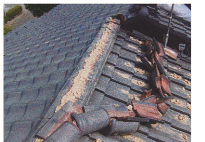
屋根被害状況
