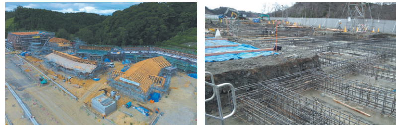
高台の広い土地に、教室棟(右奥)、特別教室棟(中央奥)、屋内運動場棟(左奥)、管理棟(右手前)、図書棟(中央手前)が立ち並び 厳しい寒さの中での基礎コンクリートの打設工事
